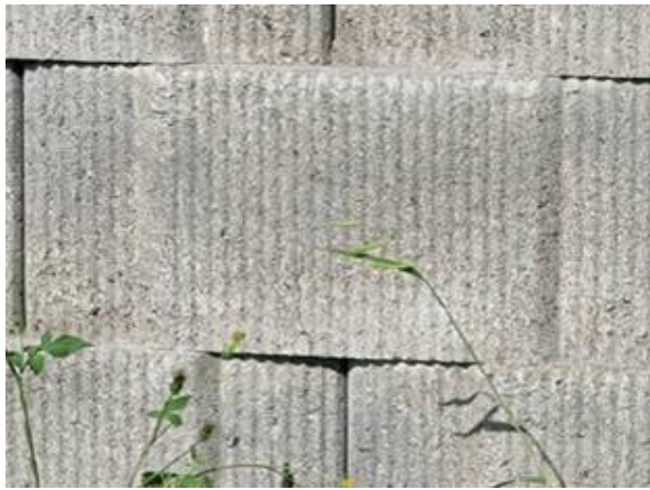
S4 블록 균열(2EA)
